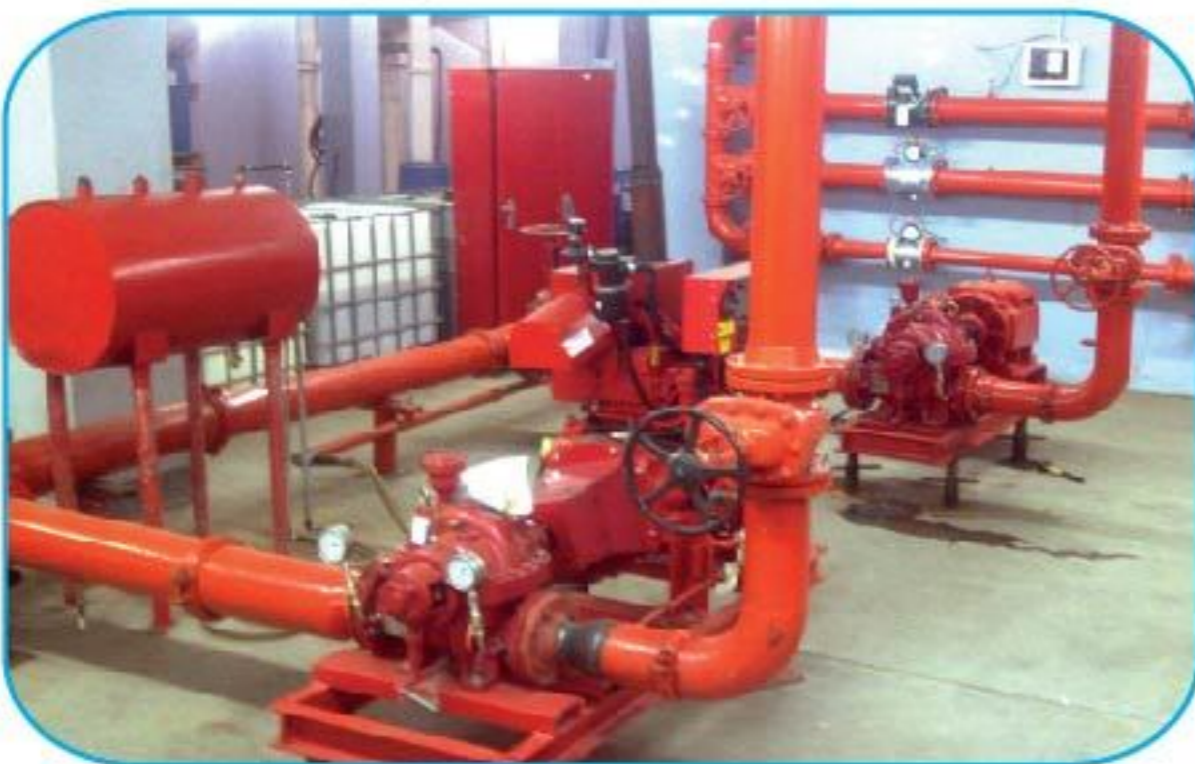
محطة اختبار مضخات الحريق UL/FM fire pumps test rig
