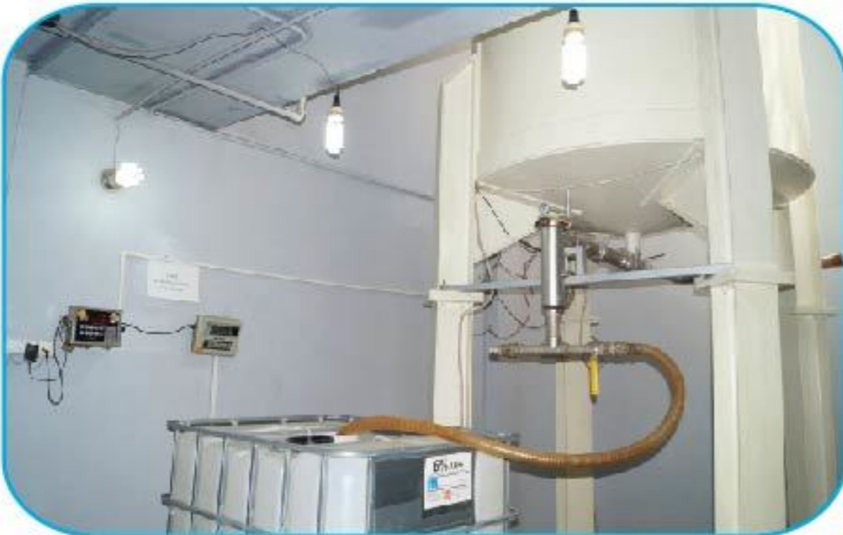
محطة خلط رغوة إطفاء الحريق UL Listed foam blending station
