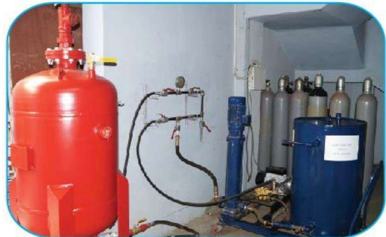
وحدة اختبار الضغط حتى 150 بار Hydrostatic pressure test station
